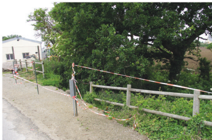
Affaissement de trottoir rue Flandres Dunkerque
